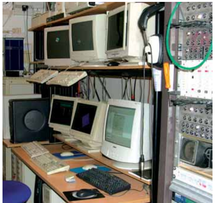
Salle des serveurs à Saint-Étienne. Il est aujourd'hui urgent de compléter et de renouveler une partie de notre matériel informatique.
